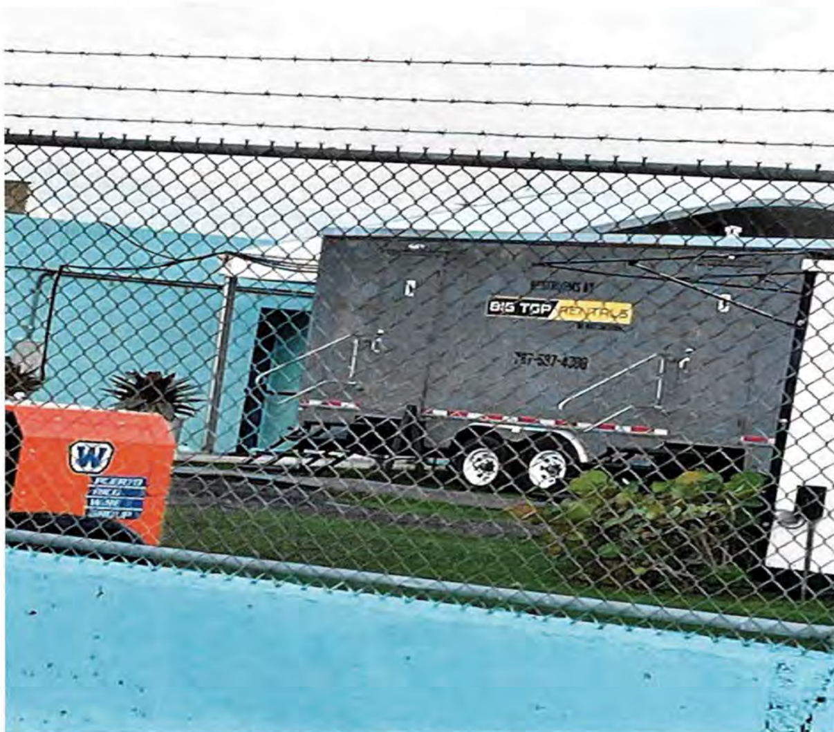
Generador a la izquierda y baños portátiles – estilo vagones.
