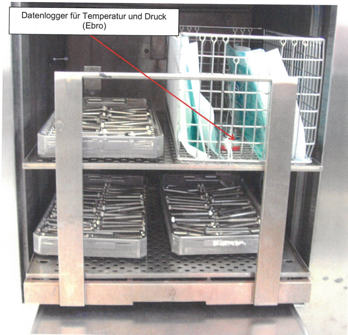
Abbildung 5: Beladung der Sterilisationskammer
