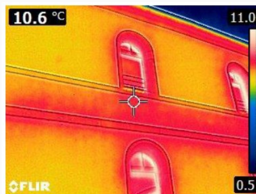
Pont thermique et déperdition par les châssis des menuiseries
