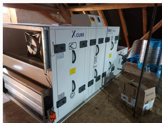
Centrale de traitement de l'air dans les combles
