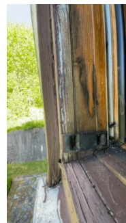
Råteskade på vinduskarm og listverk.
