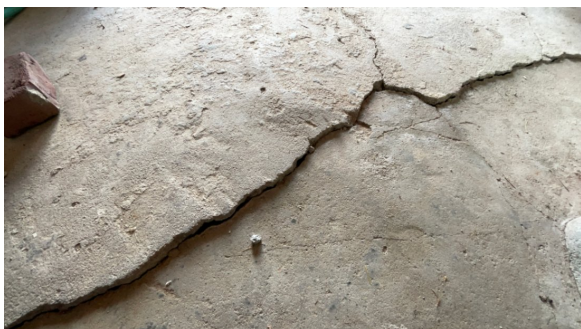
Sprekker i betonggulv.
