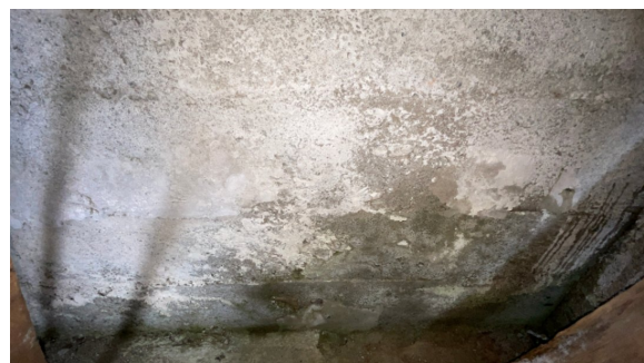
Saltutslag på grunnmur i kjeller.
