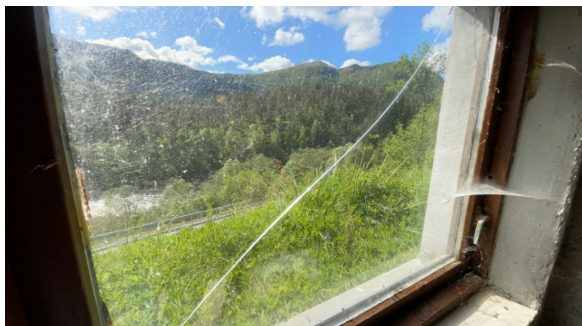
Knust rute på vindu i kjeller.
