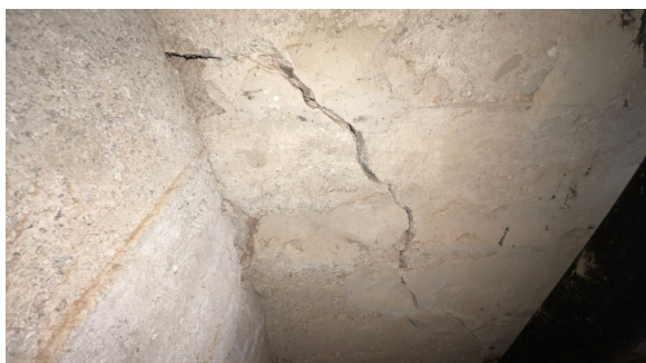
Sprekker i grunnmur.
