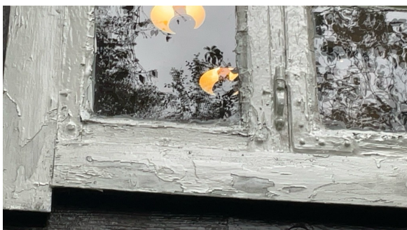
Malingslitasje på vinduskarmer.
