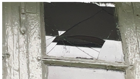
Knuste glassruter i noen av vinduene.
