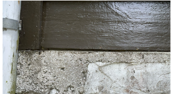
Redusert ventilering i overgang bordkledning og grunnmur.
