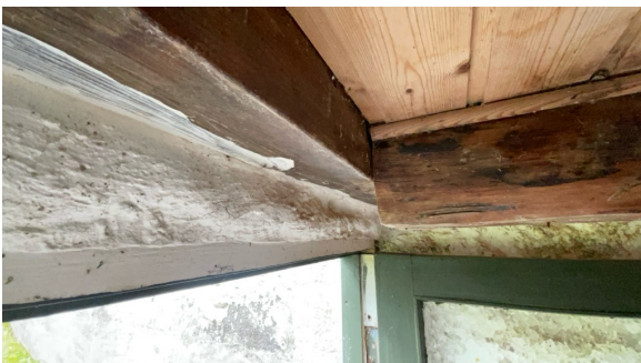
Gulvbjelke med manglende understøtting.
