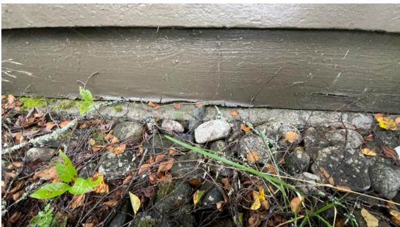
Bordkledning med manglende klaring til terreng.
