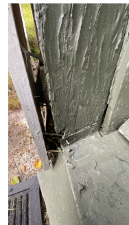
Råteskade i omramming på ytterdør og utvendig list som har løsnet fra foring.
