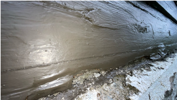
Råteskade på bordkledning.
