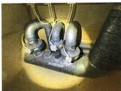
Ventilasjonsanlegg montert på loft.
