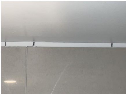
Sprekker i flisfuge i overgang vegg og tak.
