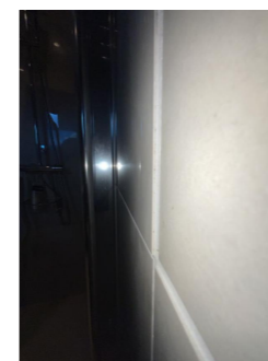
Bildet viser ujevnheter i overflatene.
