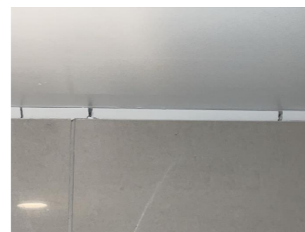
Sprekker i flisfuge i overgang vegg og tak.
