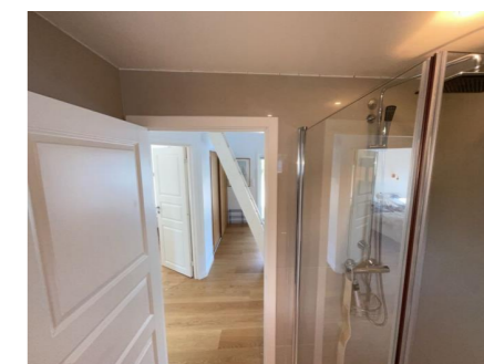
Bildet viser døråpning som er nærmere enn 1m fra våtsonen.
