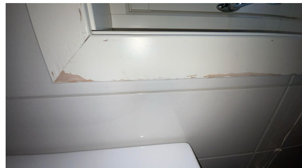
Fuktskade på listverk ved badekar.
