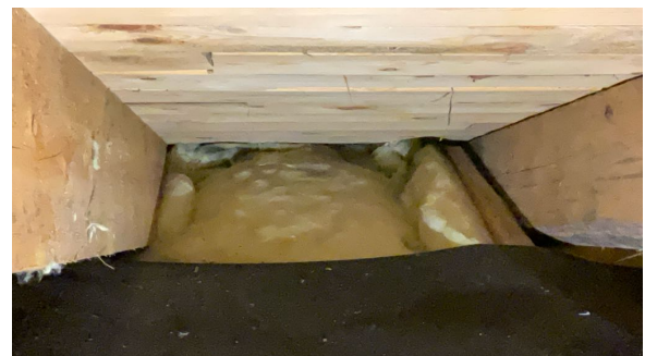
Bildet viser manglende ventilering ved gesimsene.
