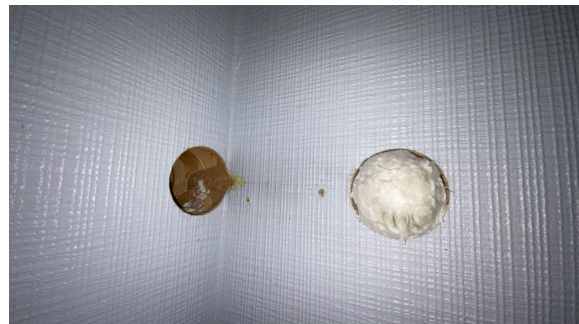
Hull i vegg i det ene soverommet og i gang.
