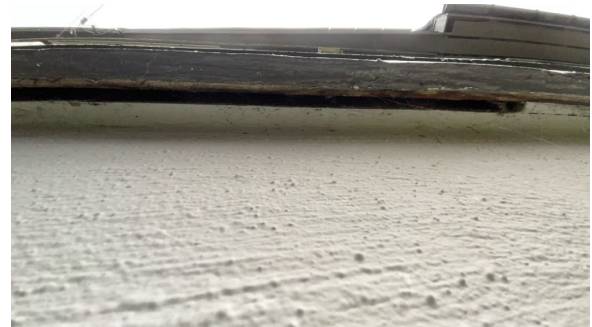
Bildet viser redusert ventilering i overgang grunnmur og bordkledning.
