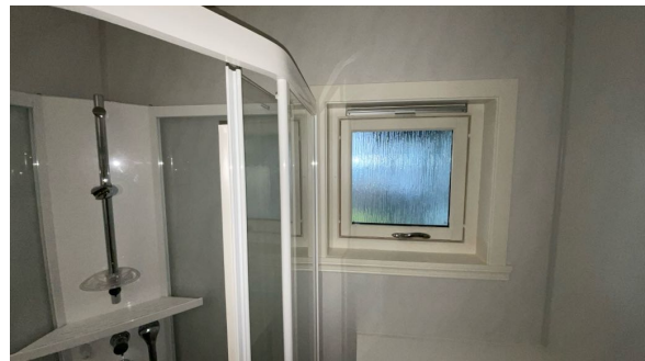
Vindu innenfor 1 meter fra dusjkabinett.
