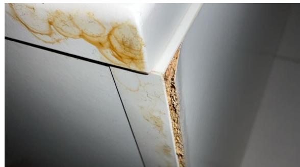
Fuktskade på finér på servantskap.
