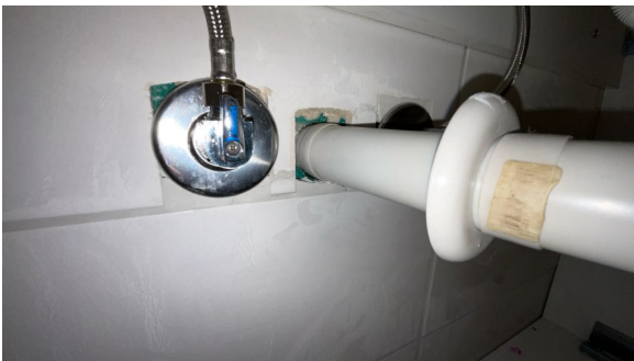
Manglende tetting i overgang membran og rørgjennomføringer i servantskap.
