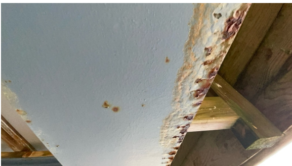
Rustskade på ståldrager.
