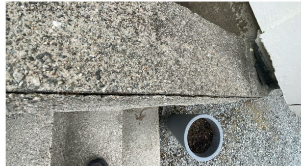
Løs murpuss på forstøtningsmur langs trapp.
