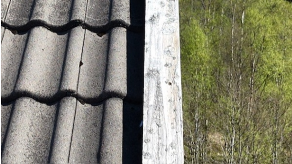
Malingsslitasje på dekkbord.
