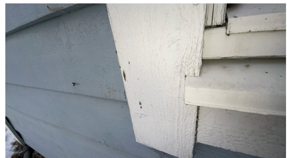
Malingslitasje på listverk.
