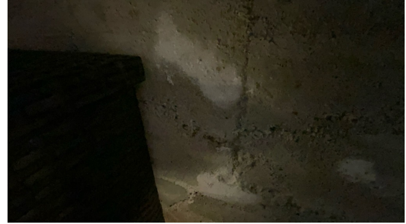
Saltutslag på grunnmur.
