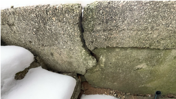
Sprekker i forstøtningsmur ved inngang til kjeller.
