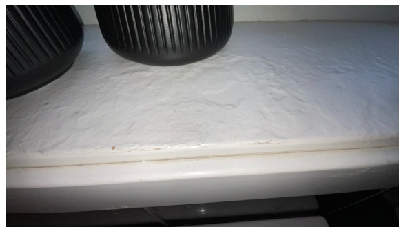
Fuktskade på vindusforing.
