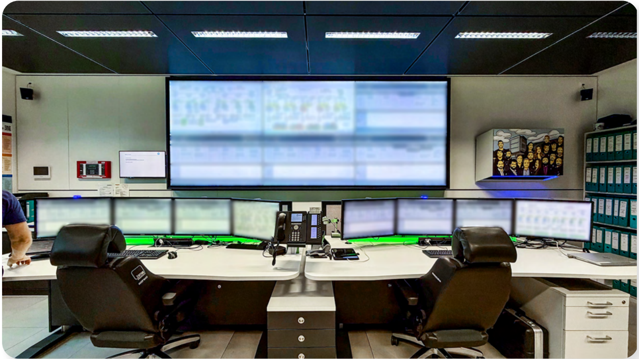
NOC In Betrieb
