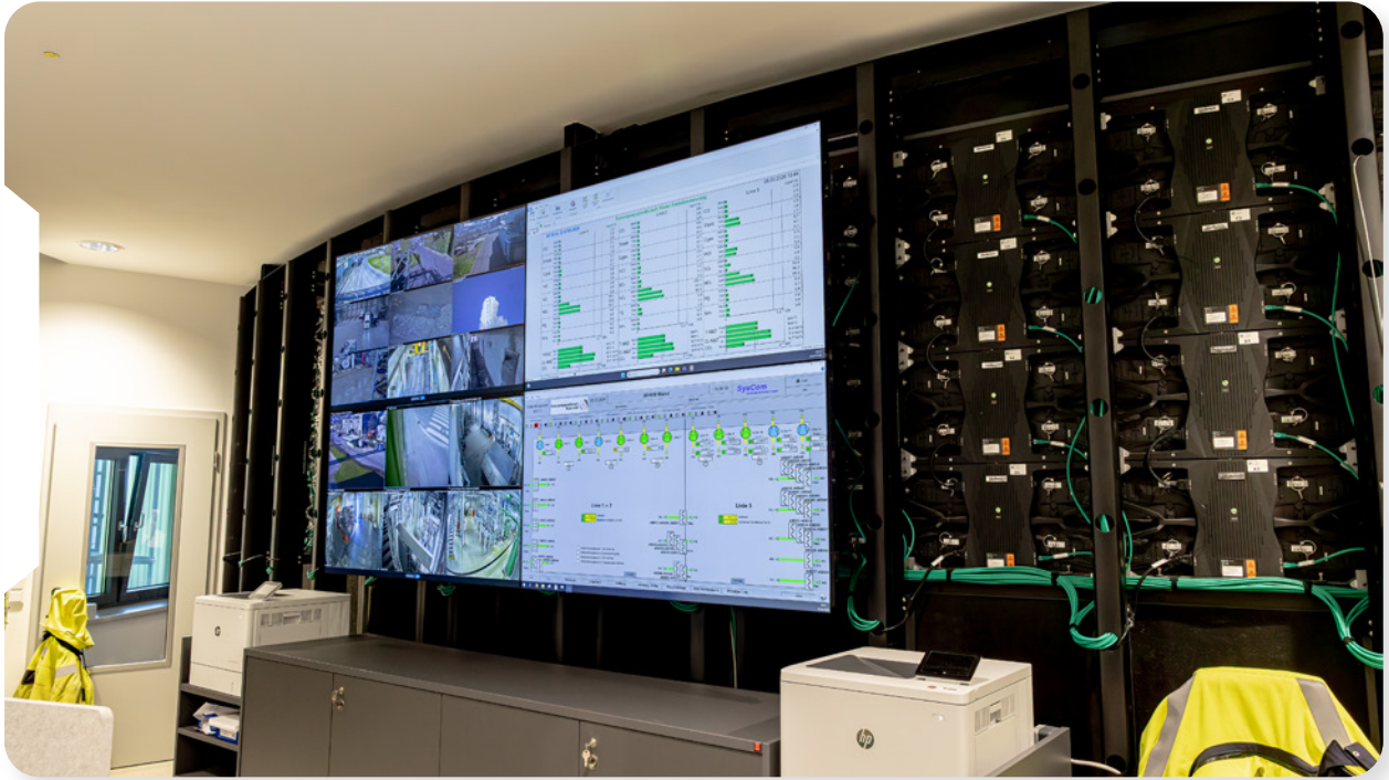
Technik 2x2 LCD-Videowall integriert auf der Rückseite der LED-Videowall
