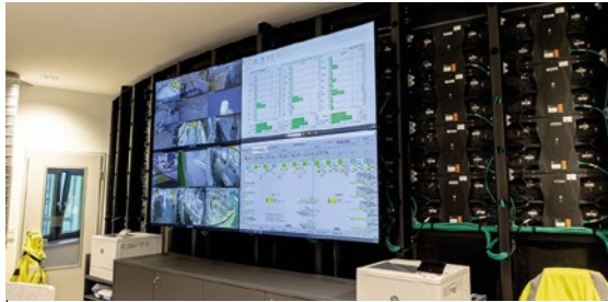
Blick hinter die Videowall: Unterkonstruktion und Verkabelung wurden speziell auf die Anforderungen der großflächigen Curved-Installation ausgelegt.
