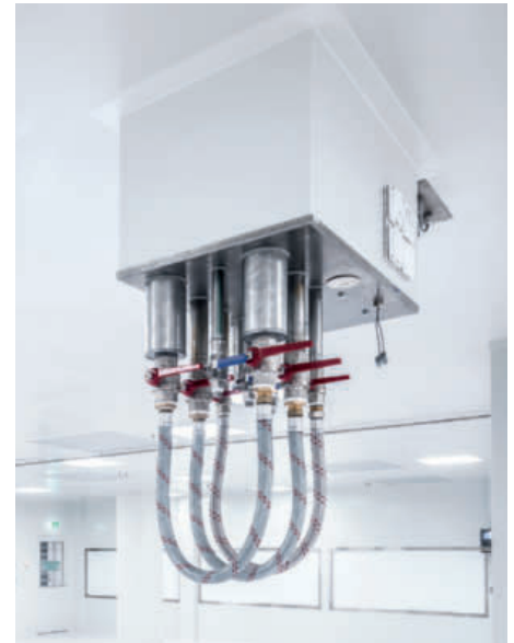
Mediensäule als Schnittstelle zur Anlage für Kälte, Druckluft, Abluft, Anlagensignale etc. Ausgestattet mit Reservepositionen für spätere Erweiterungen.
