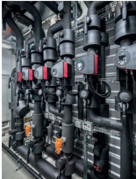
Ausgefeiltes Kältekonzept für die Versorgung von Anlagen und Haustechnik
