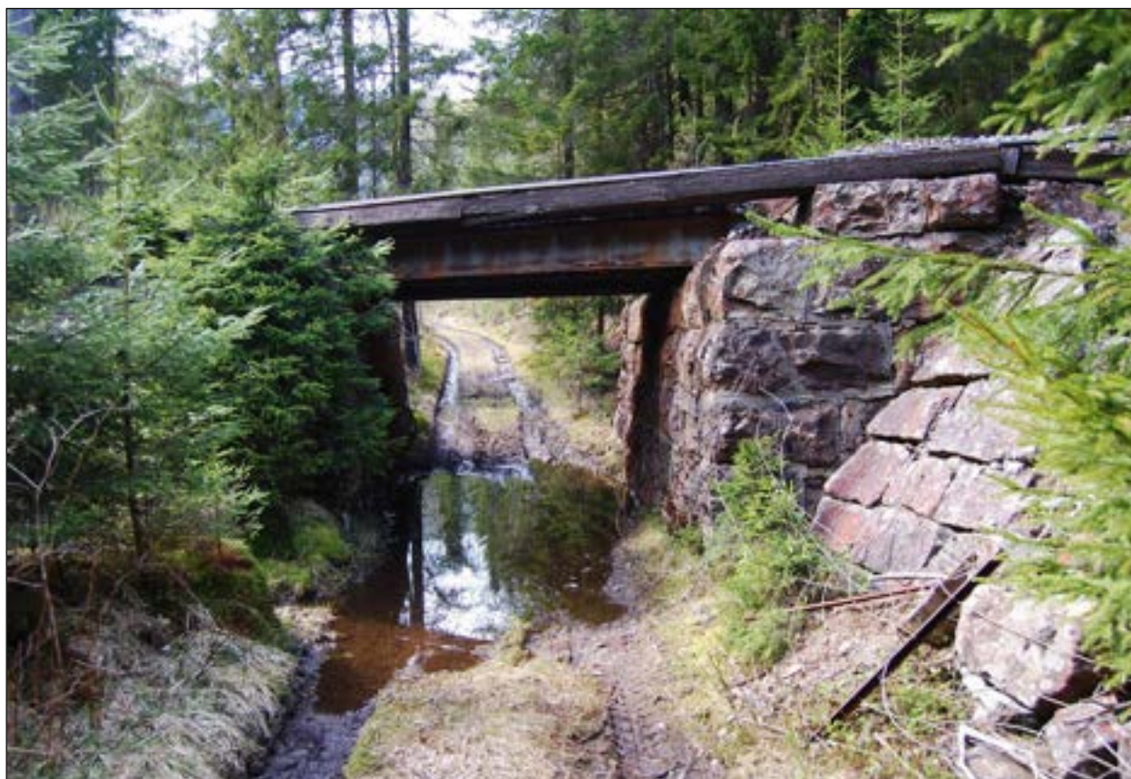
Bilde 1: De fleste stedene er det umulig å videreutvikle eksisterende bane til et moderne transportsystem. Svingene er for krappe og stigningene for sterke. Verken skinnegangen, signalsystemet eller kraftforsyningen vil kunne brukes til ny bane. Broene må tåle større krefter og tunnelene må være bredere. Traseene vil være dobbeltsporet, må være 100 % inngjerdet og ha mange og romslige under- og overganger for vilt og ferdsel. – Bildet viser en undergang på Bratsbergbanen ved Mjågetjønn, lengst sør i Sauherad kommune. Foto: © Norsk Bane AS.
