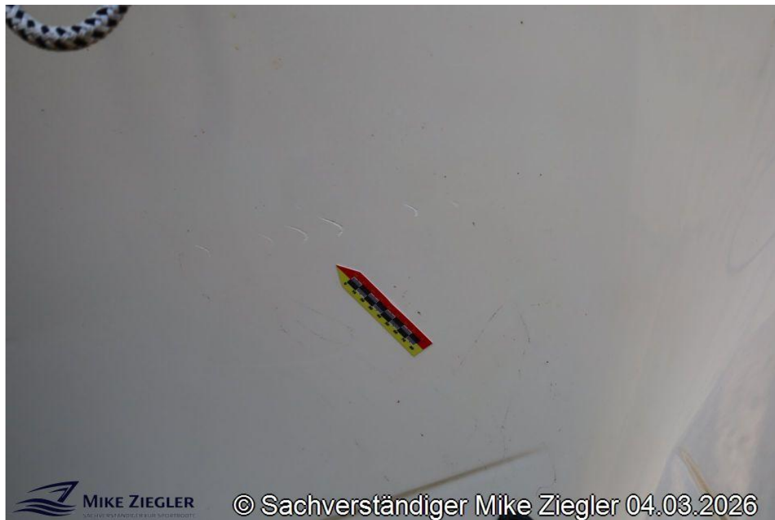
Foto 9: Detailansicht Altschaden Bugbereich Steuerbordseite
