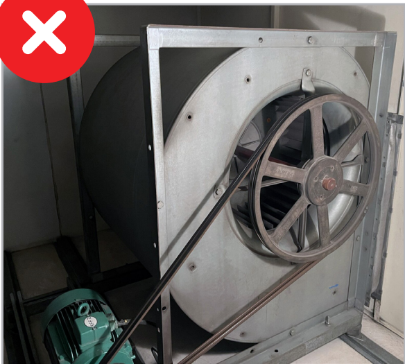
Ventilateurs à courroie inefficaces, comme ceux installés dans la plupart des anciens appareils de traitement d'air.
