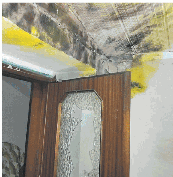
Dopo il fulmine la "casa dei nonni" non è più abitabile. I danni sono stati pesantissimi FOTO FRESCHI
