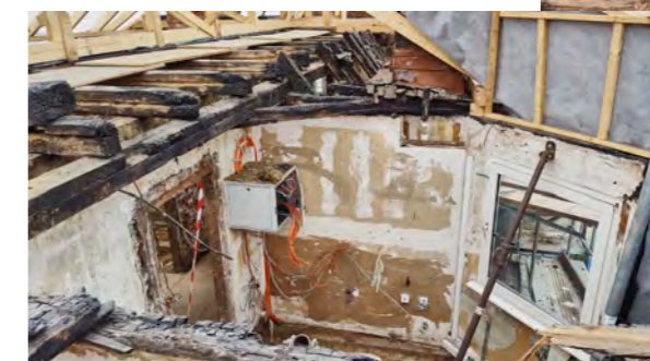
Angebrannte Balkenköpfe vor der Sanierung
