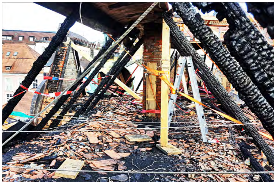
Erste Sicherungsmaßnahmen nach dem Brand
