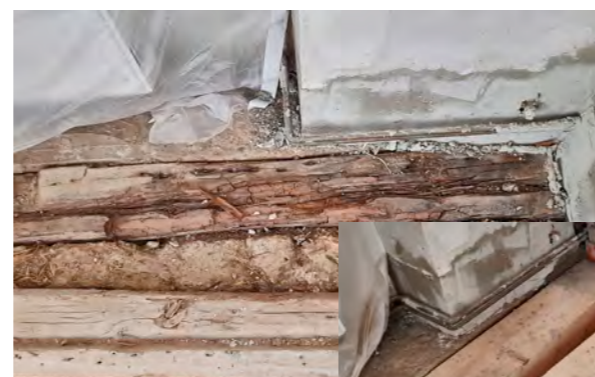
Bei der Sanierung tauchten auch alte Wasserschäden auf
