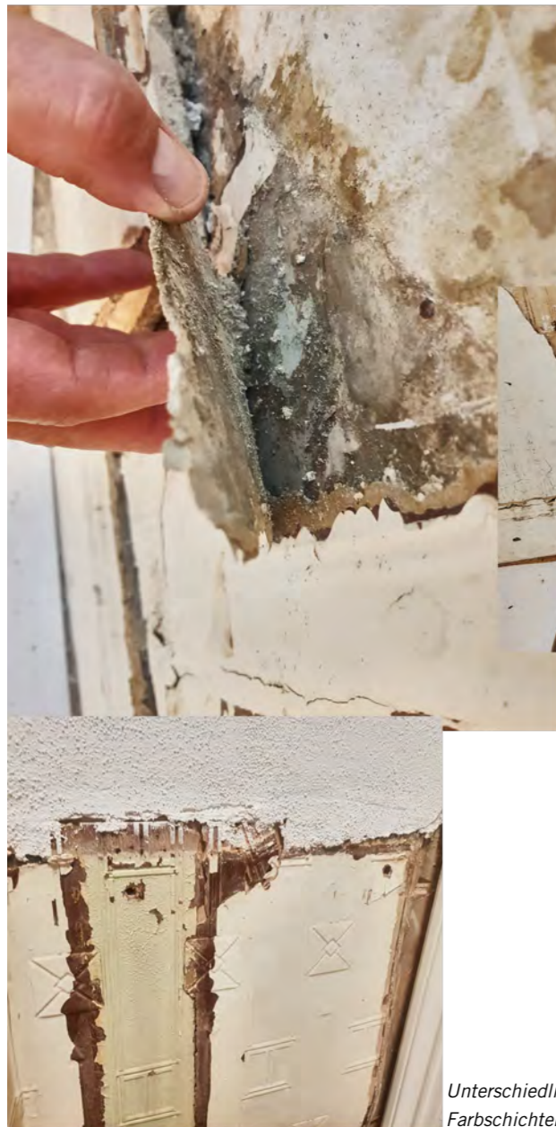
Schimmelbefall unter der Tapete
