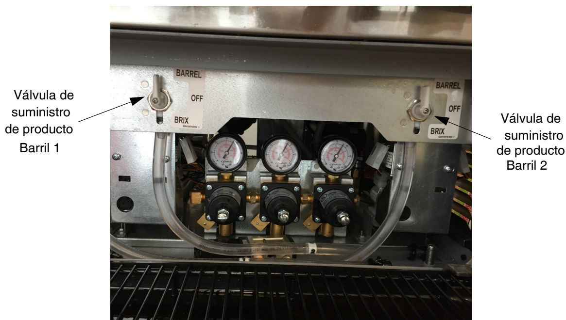
Válvulas que se muestra en la posición de producto sin Panel contra Salpico
