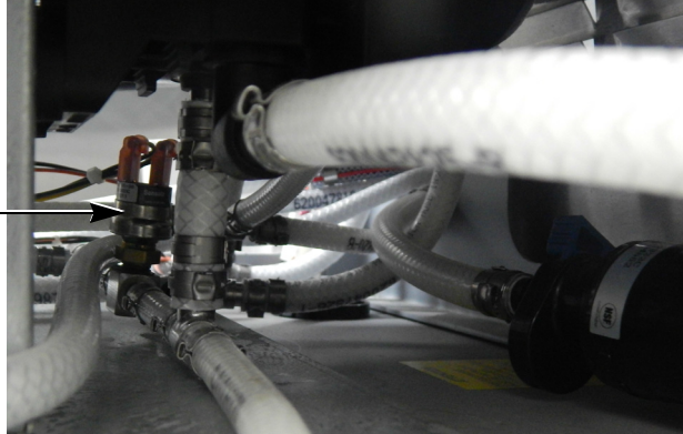
Figura 53. Vista Del Interruptor De Presión De Agua
