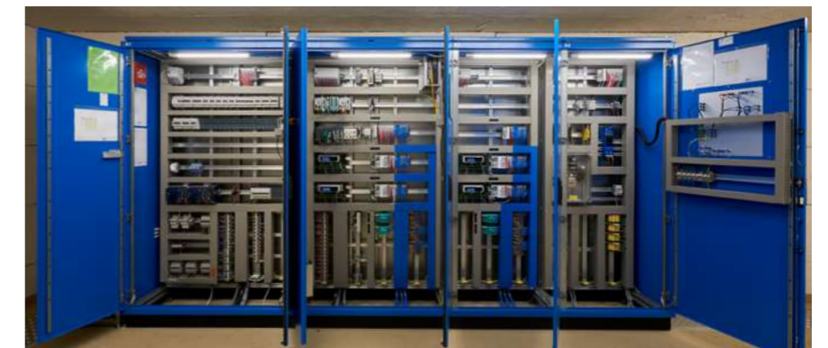
Nouveaux tableaux électriques du poste douanier de La Cure.
