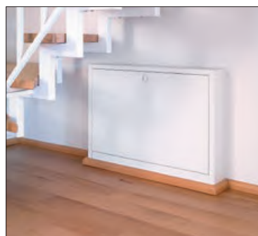
Verteilerschrank unter der Treppe
