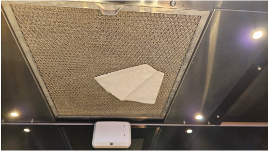
Funksjonstest av ventilator.
