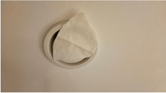
Funksjonstest av avtrekk.
