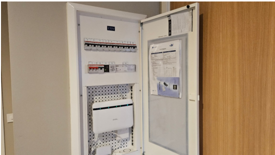
Kontroll av el-skap.
