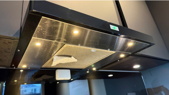
Funksjonstest av ventilator.
