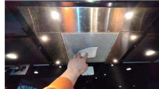
Funksjonstest av ventilator.
