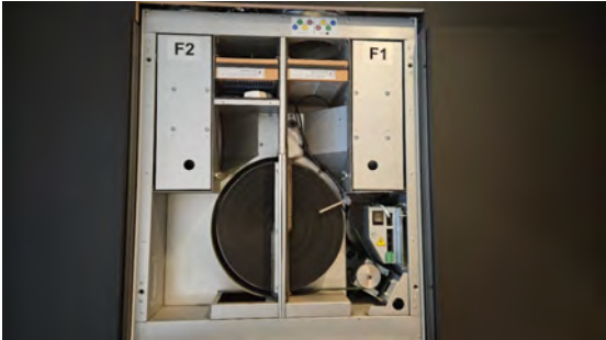
Kontroll av ventilasjonsaggregat.
