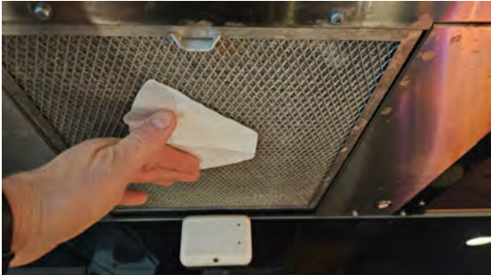
Funksjonstest av ventilator.
