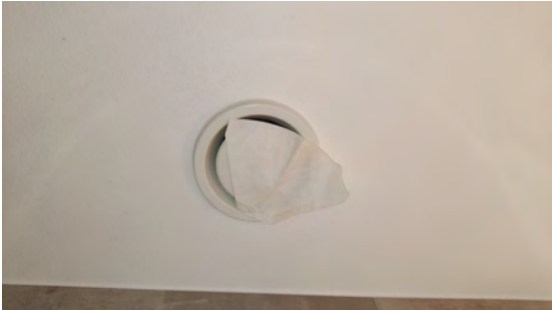
Funksjonstest av avtrekk.
