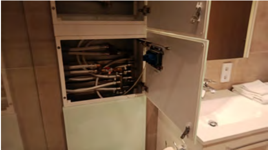
Rørskap med stoppekra
