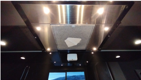
Funksjonstest av ventilator.
