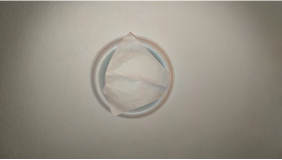
Funksjonstest av avtrekk.
