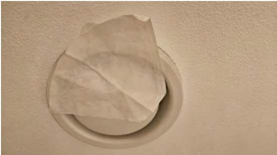
Funksjonstest av avtrekk.
