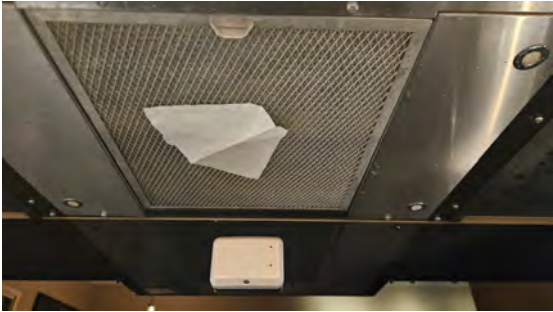
Funksjonstest av ventilator.
