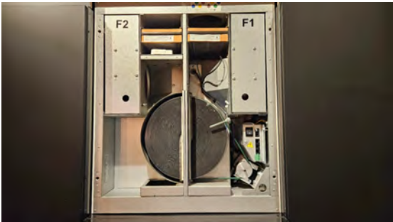
Kontroll av ventilasjonsaggregat.
