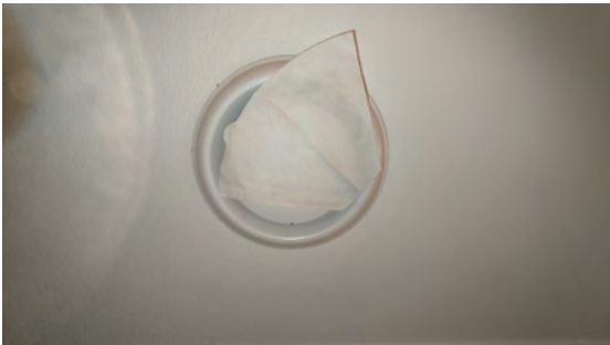
Funksjonstest av avtrekk.
