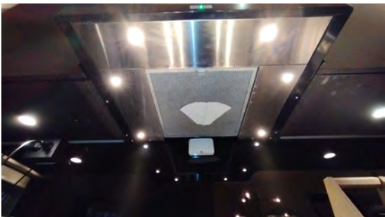
Funksjonstest av ventilator.
