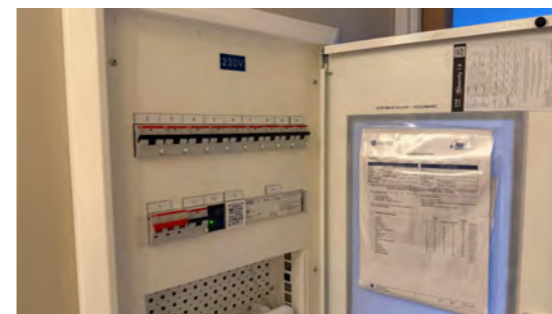
Kontroll av el-skap.
