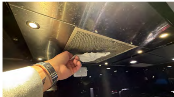
Funksjonstest av ventilator.
