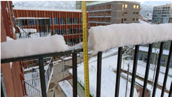
Kontroll av rekkverkhøyde.
