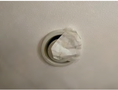
Funksjonstest av avtrekk.
