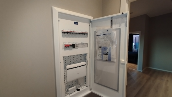
Kontroll av el-skap.
