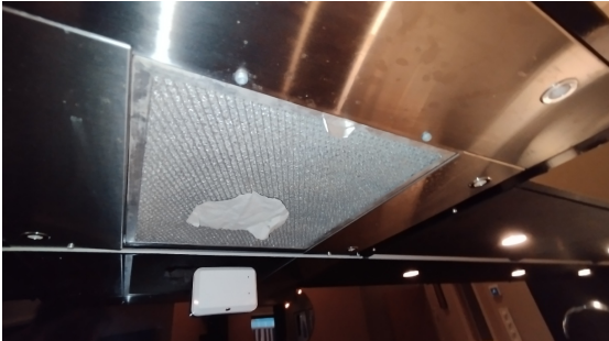
Funksjonstest av ventilator.
