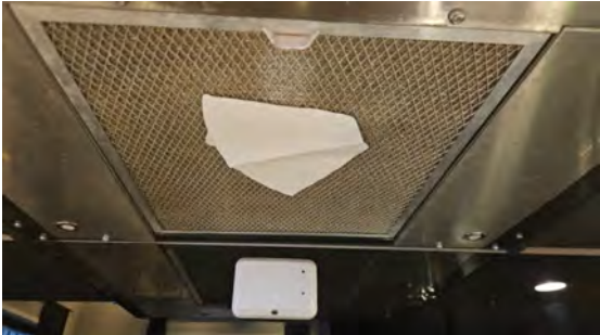
Funksjonstest av ventilator.
