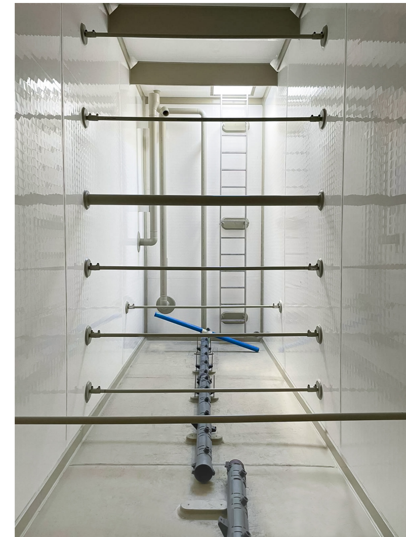
Hohes Fassungsvermögen: Im neuen Pufferspeicher wird Abwasser aus der Produktion sicher zwischengespeichert
