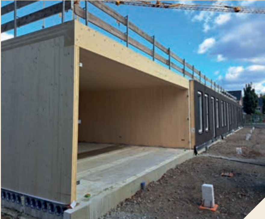
Het CLT casco in combinatie met het duurzame bouwsysteem, afkomstig uit de Slimme Huizenfabriek van Plegt-Vos
