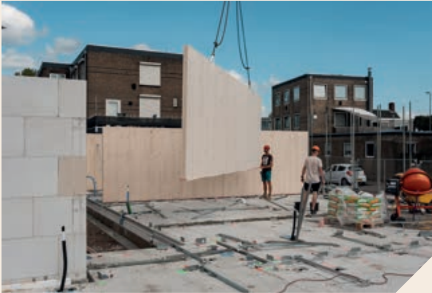
De galerij van Orthen-Links fase 4. Foto gemaakt in maart 2026, voor het aanbrengen van de hergebruikte stalen hekken. Foto: Photo Prestige – Edwin van Zandvoort
