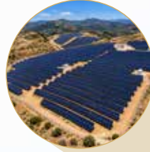
Erzurum AŞKALE ARAZI GES 8.991 kWe / 10.808,64 kWp
