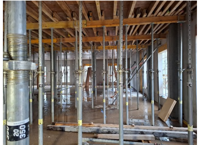
Betonierte Decke über dem ersten Untergeschoss im IRM Neubau an der Socinstrasse
