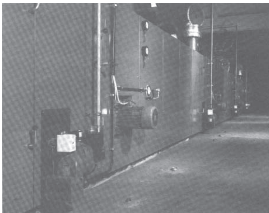
Fig.4 ABIG - Industriebrenner an einem Textiltrockner
