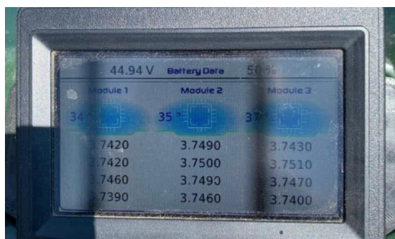
► Battery data mid-route: 44.94 V, 50 %, Modules 34/35/37°C
