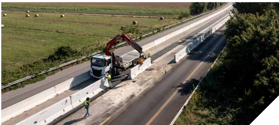
Barriere di sicurezza stradale tipo New Jersey
