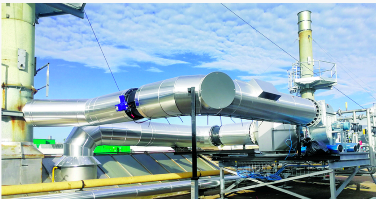
Illustration : infrastructure de récupération de la chaleur fatale installée par Dalkia © L'Usine Nouvelle
